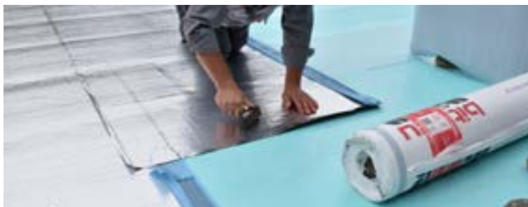
Polaganje prvog sloja FIBRANhydro ANTI RADON 1,5sk na čistu podlogu i poprečno na sloj FIBRANxps ploča. Preklopi trebaju biti široki najmanje 15 cm.
