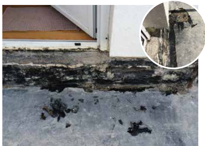
Skidajući se slojeve do parne barijere pokazalo se da je voda prodrla i ispod nje.
