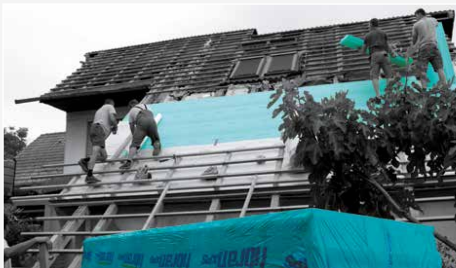
Energetski najučinkovitije sustavno rješenje za sanaciju kosog krova stambenog potkrovlja je kombinacija reflektirajuće sekundarne membrane FIBRANskin VENT SILVER i toplinske izolacije FIBRANxps MAESTRO .
