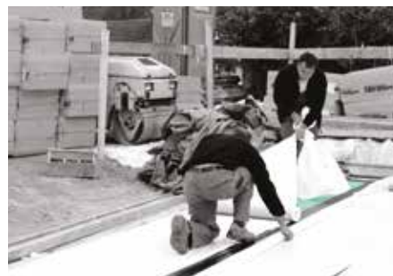
Na precizno položen prvi sloj toplinske izolacije FIBRANxps odgovarajuće debljine i čvrstoće, zalijepimo dvostrano samoljepljivu hidroizolaciju FIBRANhydro SEISMIC T-1,8 sk/sk.
