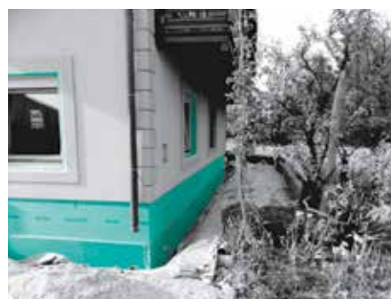
Rješavanje toplinskih mostova na špaletama i toplinska izolacija fasade podnožja zida (sokla) FIBRANxps ETICS .
